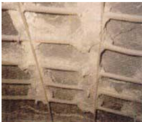
Приложение 1: Разрушение бетонной облицовки В Евротоннеле; 1996. 3
