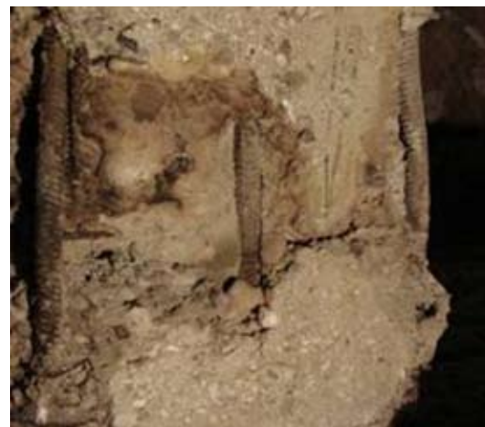
Фото 1. Колонна на отм. 348,80 м после трехстороннего огневого воздействия. Разрушение узла соединения сборной и монолитной частей. Выгиб арматурных стержней
