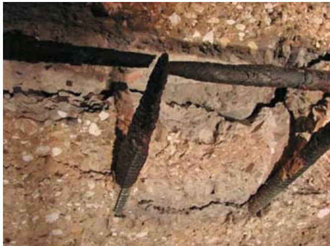
Фото 2. Разрушение силовой арматуры и бетона плиты перекрытия над очагом пожара №1 в зоне сопряжения плиты со стенкой генератора ГА-1. Наблюдается эффект расплавления металла в металле (характерно для нагрева конструкций до 1400°C).
